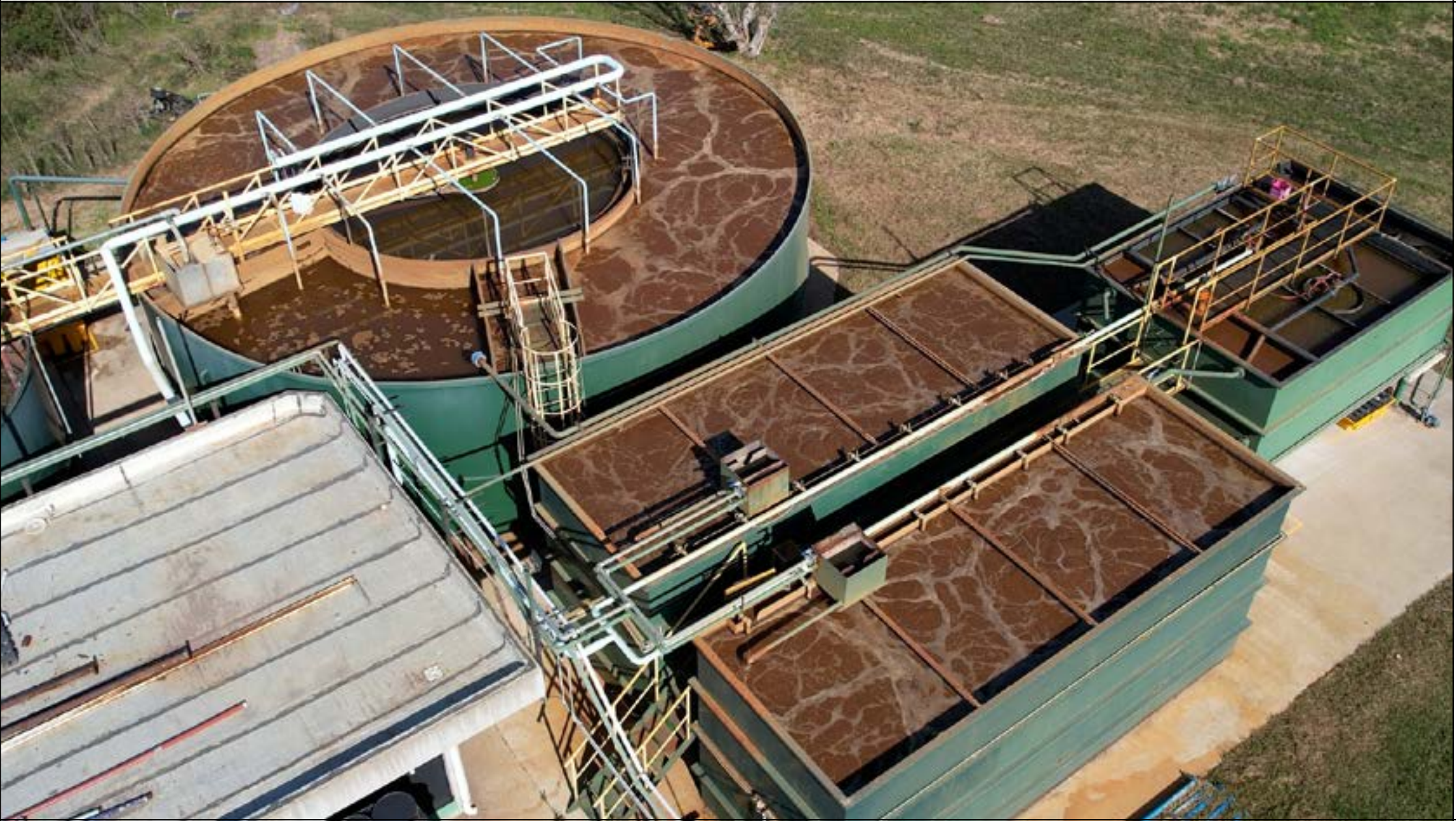
Planta de tratamiento de efluentes
